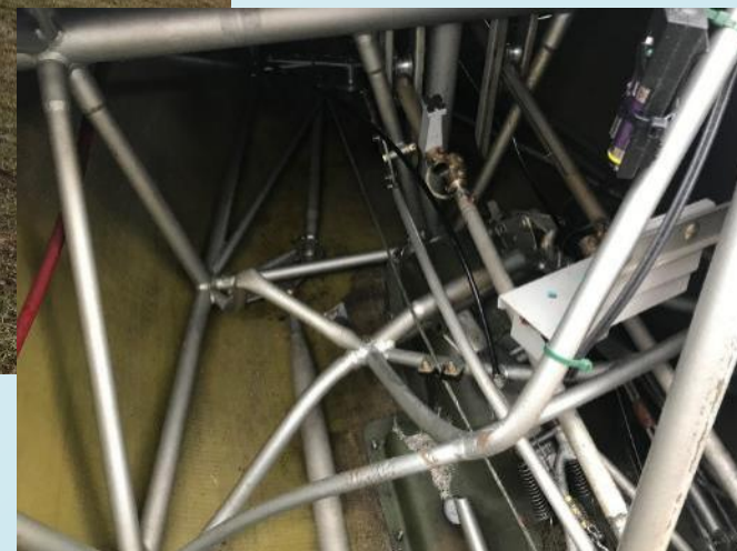
Zborcená vnitřní příhradová konstrukce trupu.
