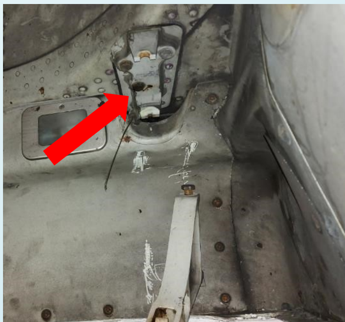
Poškození zadního závěsu
